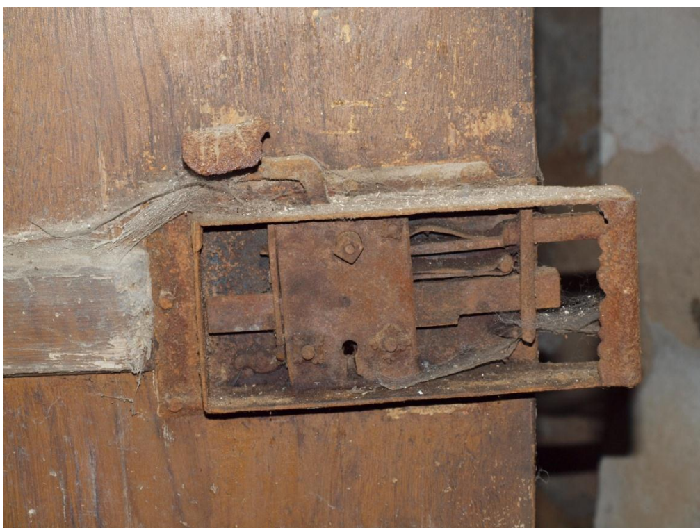
Dveře F – detail původního zámku z vnitřní a vnější strany. U původního zámku chybí krycí plech, který bude v rámci repase dveří doplněn.
