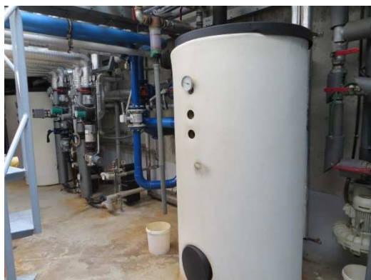
Příprava teplé vody
