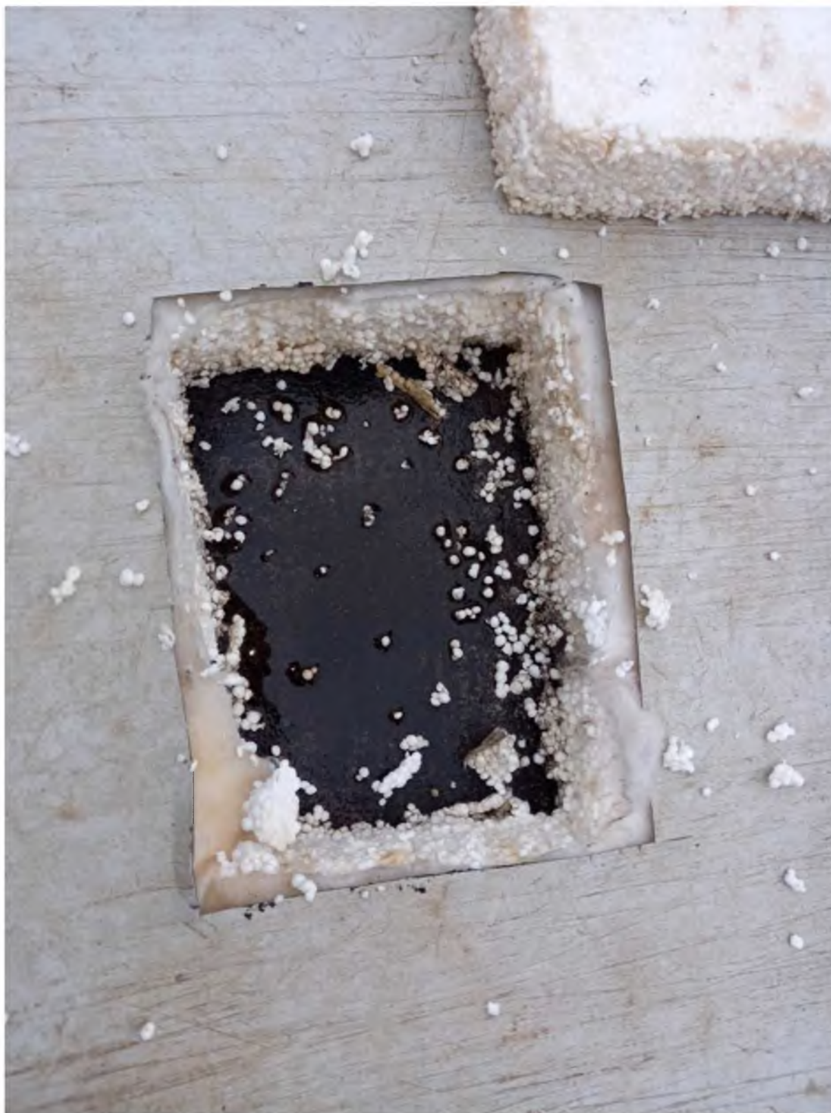
Fotografie 6 – Hladina vody na původní hydroizolaci.
