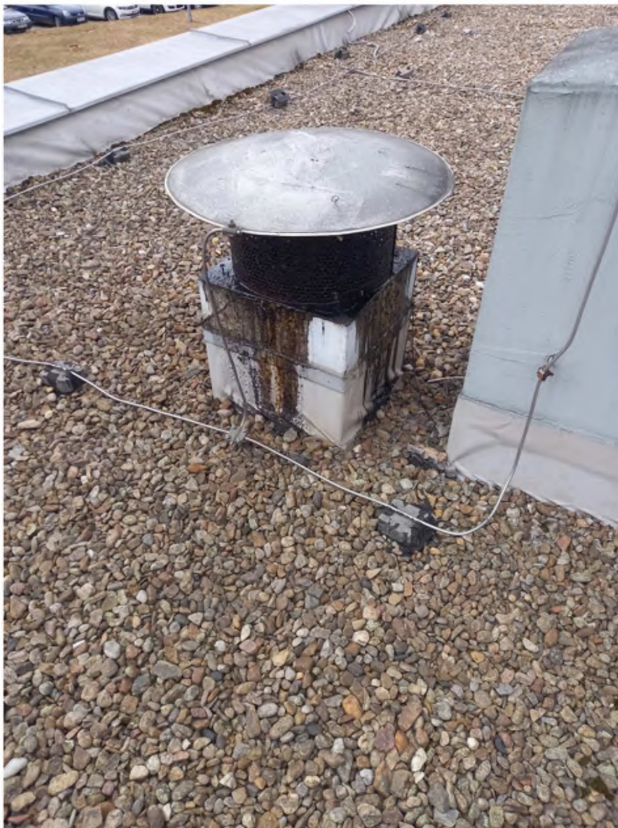
Fotografie 8 – Oleje a mastnota z odvětrávacího prvku mohly také degradovat hydroizolaci.
