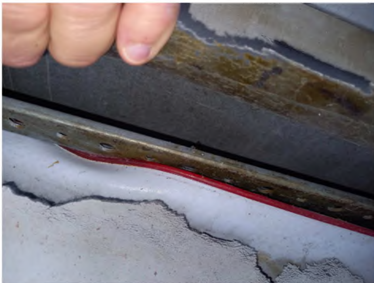
Fotografie 2 – Defekt hydroizolace v návaznosti na vyšší stěnu objektu.
