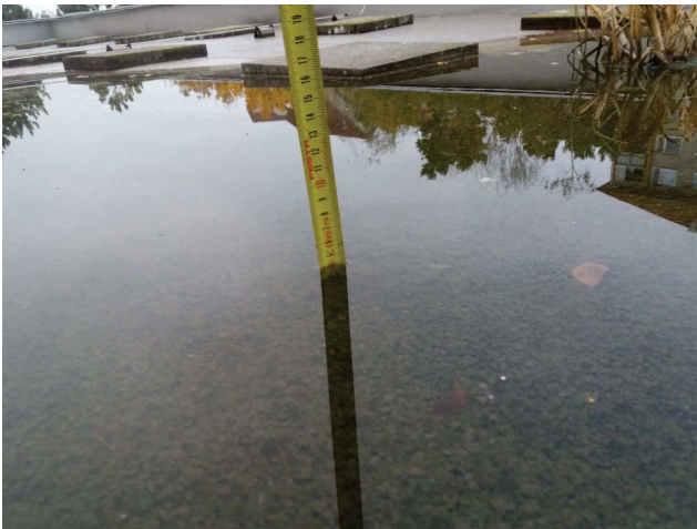
foto/22/ Pohled na stojící vodu výšky 50 mm s nečistotami a počáteční růst rákosí u střechy A
