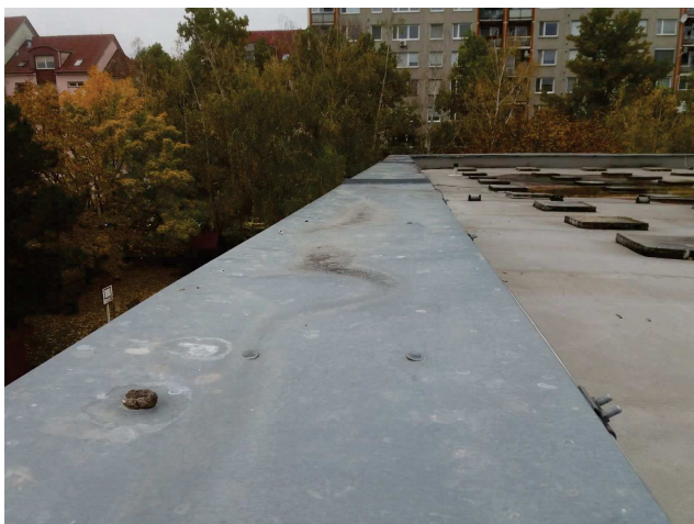
foto/38/ Pohled na oplechování atiky a stopy po stojící vodě u střecha A
