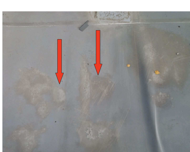
foto/31/ Pohled na degradovanou fólii u střechy D
