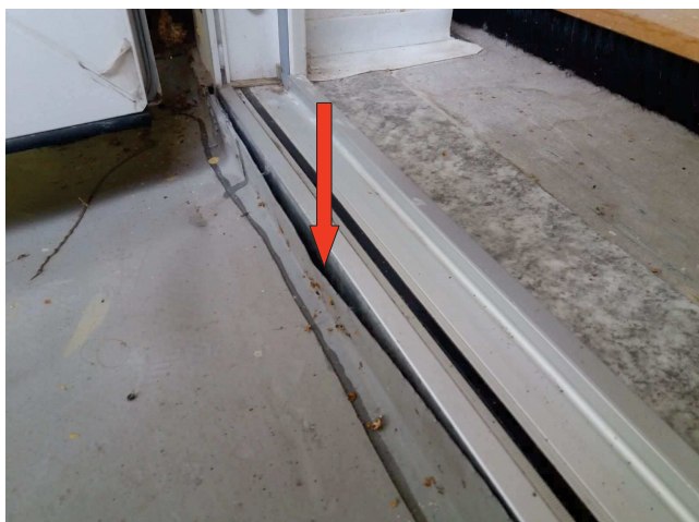
foto/36/ Pohled na ukončení fólie na koutové liště a její netěsnost v místě balkonových dveří u střechy E
