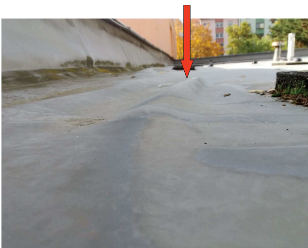
foto/30/ Pohled zvlněnou fólii u střechy D
