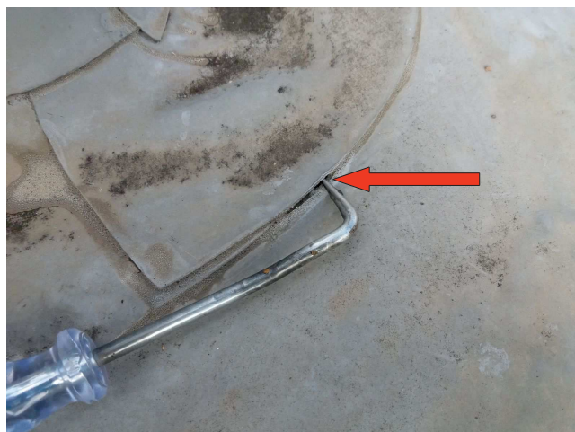
foto/45/ Pohled na netěsnost u napojení PVC-P tvarovky hlavní hydroizolační vrstvu
