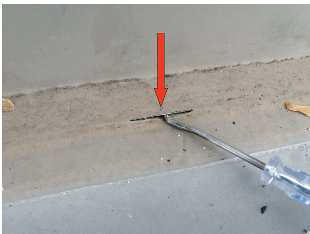
foto/26/ Pohled na netěsnosti u střechy B
