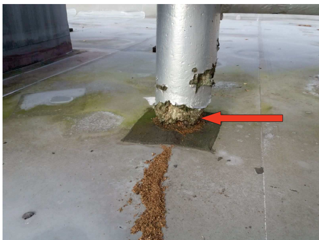
foto/44/ Pohled na vstup u vzduchotechniky
