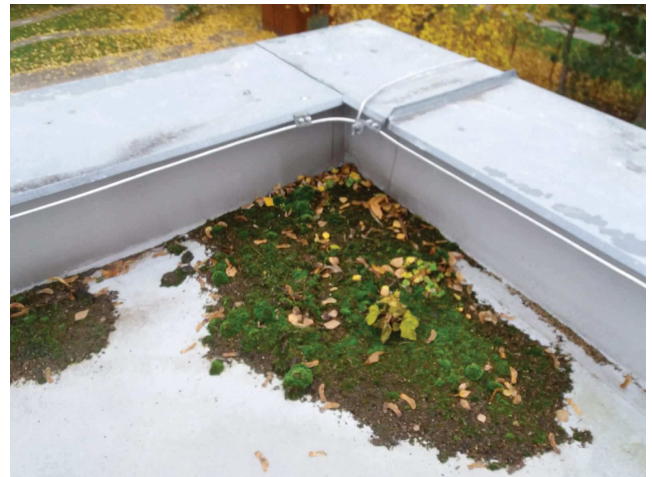
foto/23/ Pohled na nahromaděné nečistoty a růst mechů na povrchu fólie u střechy A
