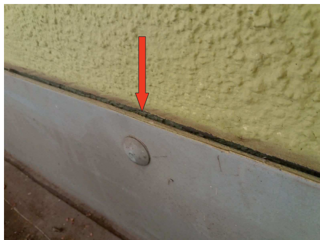
foto/37/ Pohled na ukončení fólie na stěnové liště a její netěsnost na zděném zábradlí u střechy E
