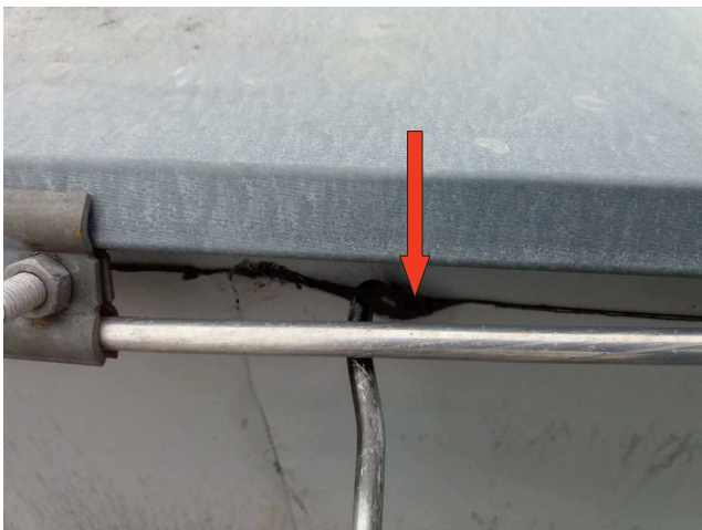
foto/34/ Pohled na ukončení fólie a netěsnost na koruně atiky u střechy B
