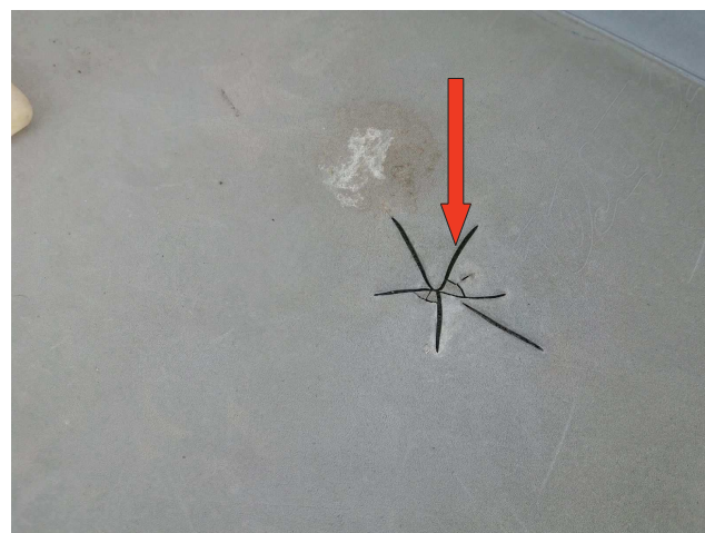
foto/29/ Pohled degradaci fólie u střechy C
