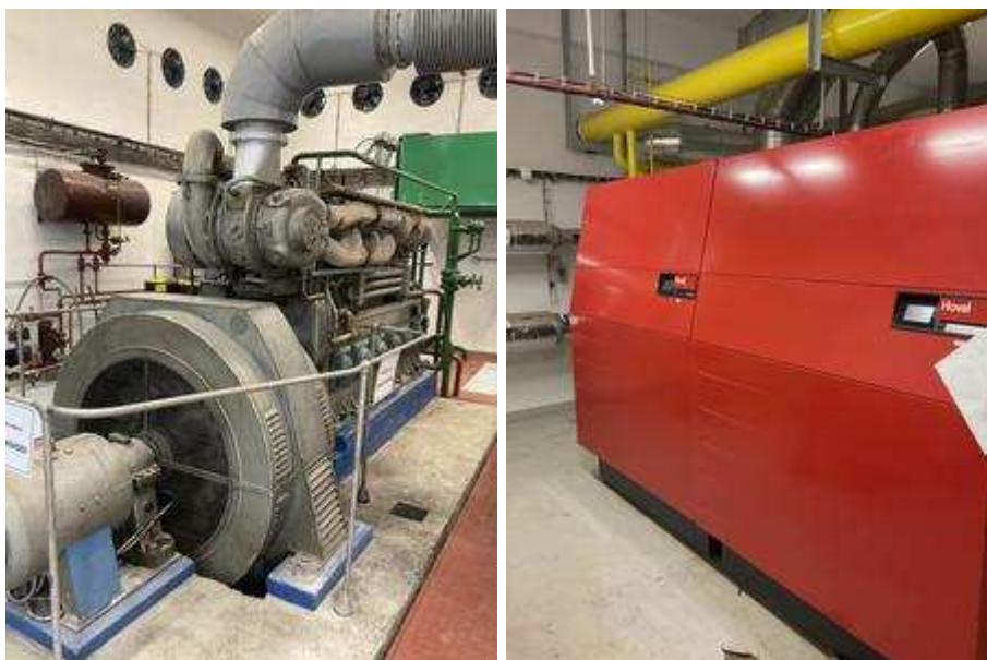
Obrázek 8 a 9 - dieselagregát a kotelna
