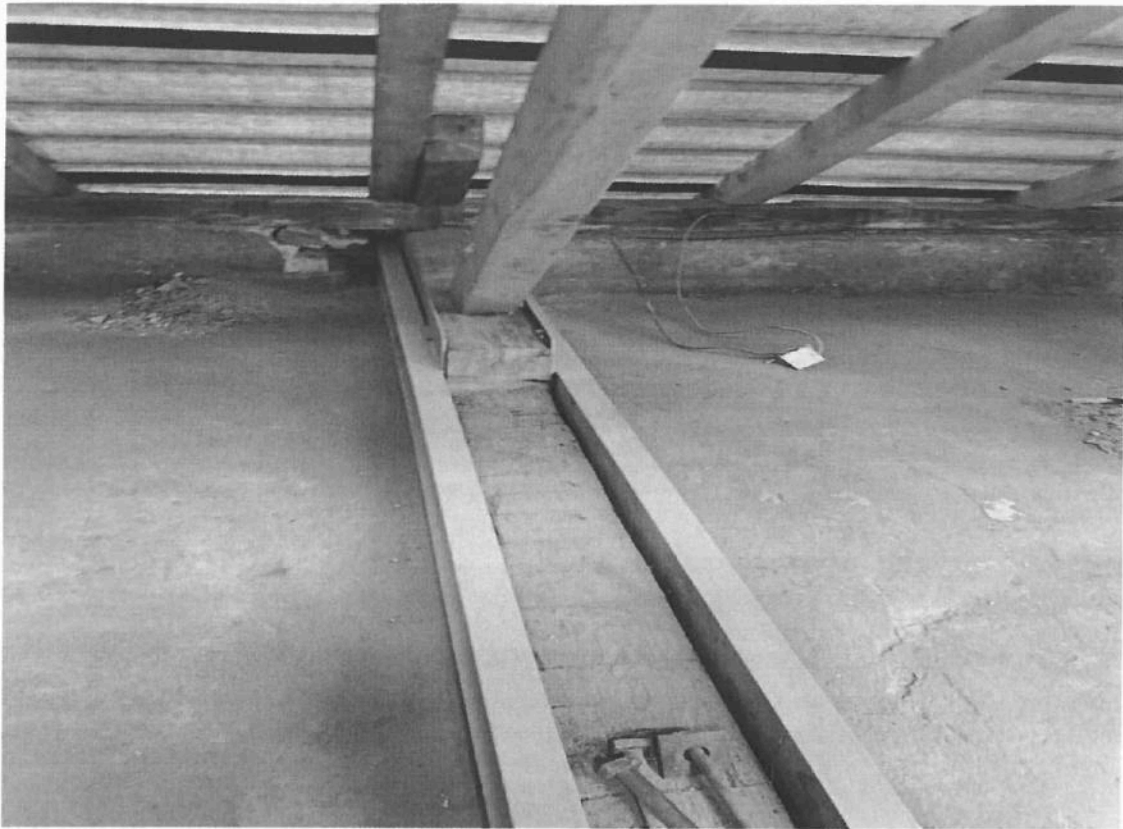
Oslabený vazný trám
