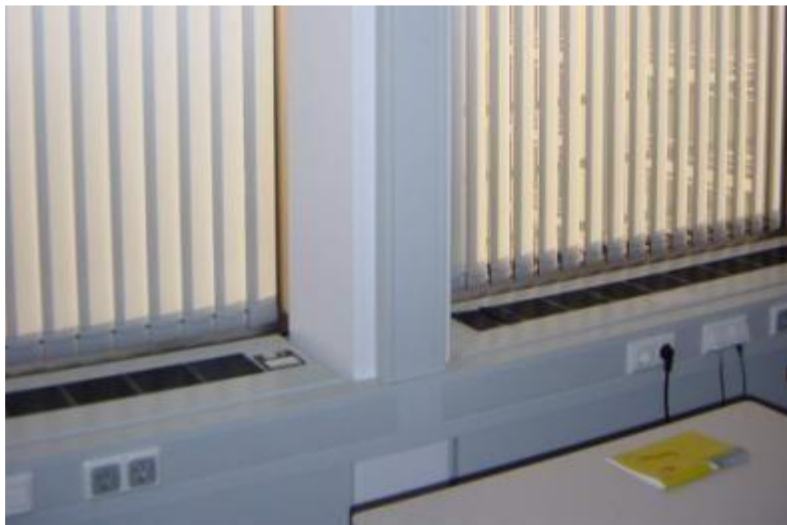
Obrázek 22 svislé a vodorovné vedení kabeláže v podokenním žlabu
