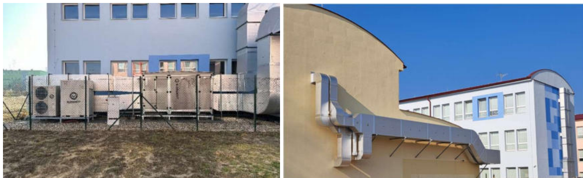
Obrázek 29 – VZT jednotka a vedení rozvodů po fasádě
