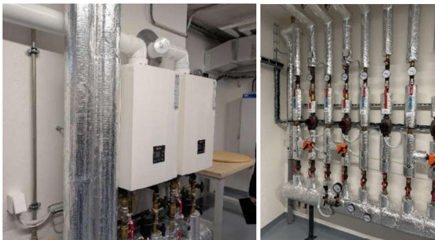
Obrázek 102 – Plynové kotle, R/S
