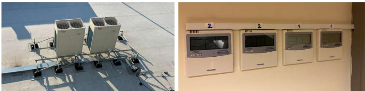
Obrázek 16 – Chladicí zařízení s ovládáním
