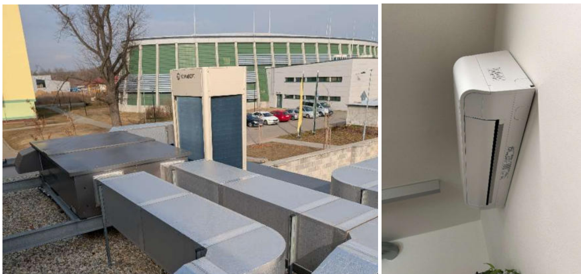
Obrázek 105 – VRF jednotka, vnitřní jednotky
