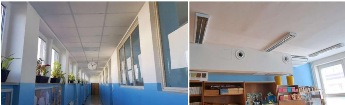
Obrázek 30 - Osvětlení chodby a učebny
