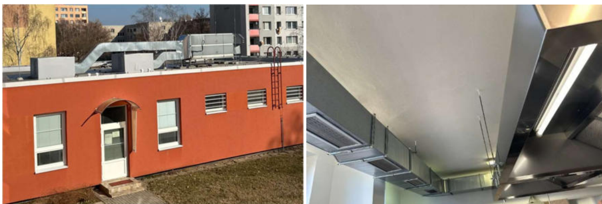
Obrázek 47 – VZT jednotka, rozvody v kuchyni
