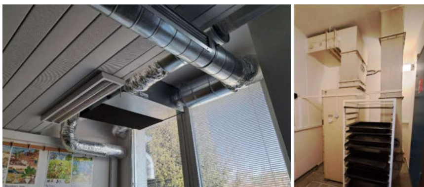
Obrázek 24 – VZT jednotka v učebně a pro kuchyň
