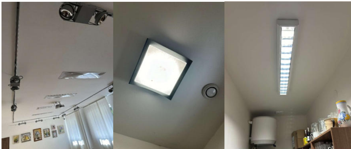
Obrázek 79 – Osvětlení v objektu
