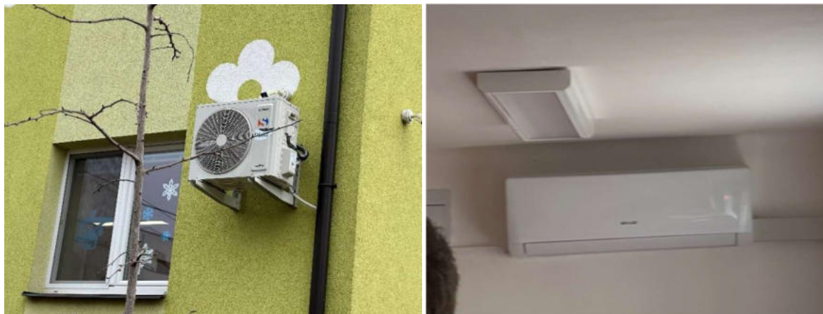
Obrázek 99 – Split jednotka, vnitřní jednotky
