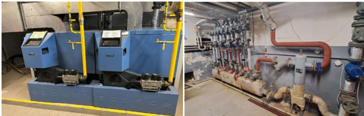
Obrázek 19 – Plynové kotle s R/S
