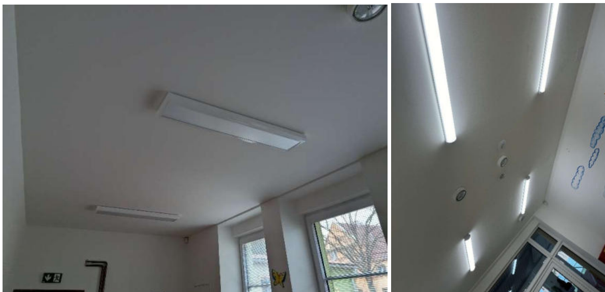
Obrázek 89 – Osvětlení jídelny, chodby
