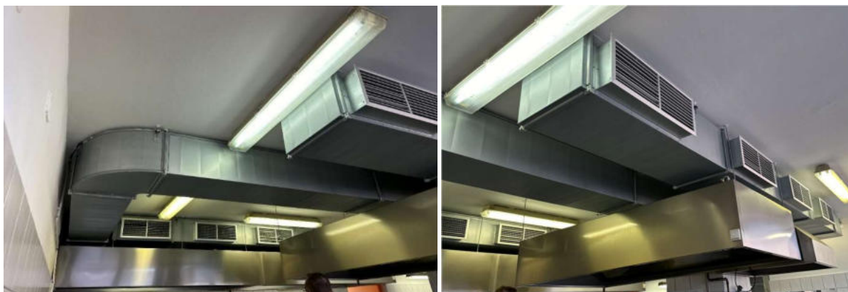
Obrázek 67 – VZT rozvody v kuchyni
