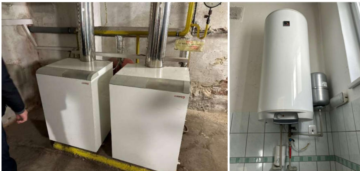
Obrázek 93 – Plynové kotle, ohřev TUV
