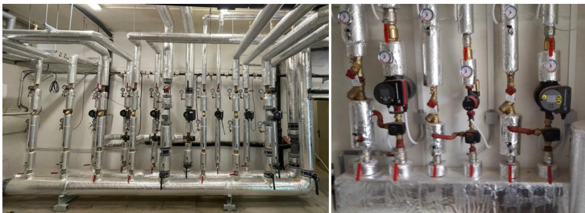
Obr. 2.2.2.: topné větve po rekonstrukci
