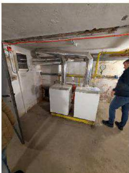
Stávající plynové kotle
