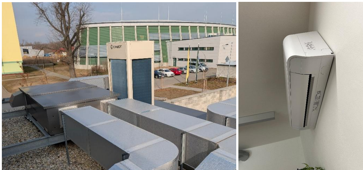
Obrázek 105 – VRF jednotka, vnitřní jednotky
