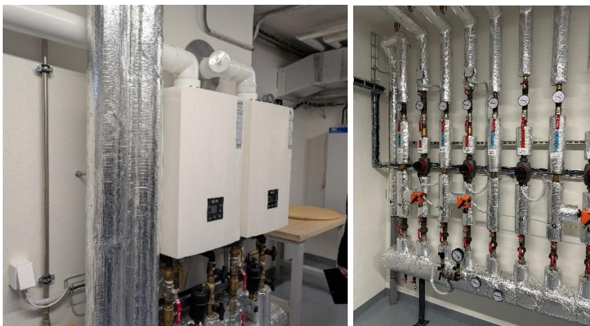
Obrázek 102 – Plynové kotle, R/S
