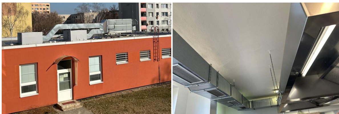
Obrázek 47 – VZT jednotka, rozvody v kuchyni
