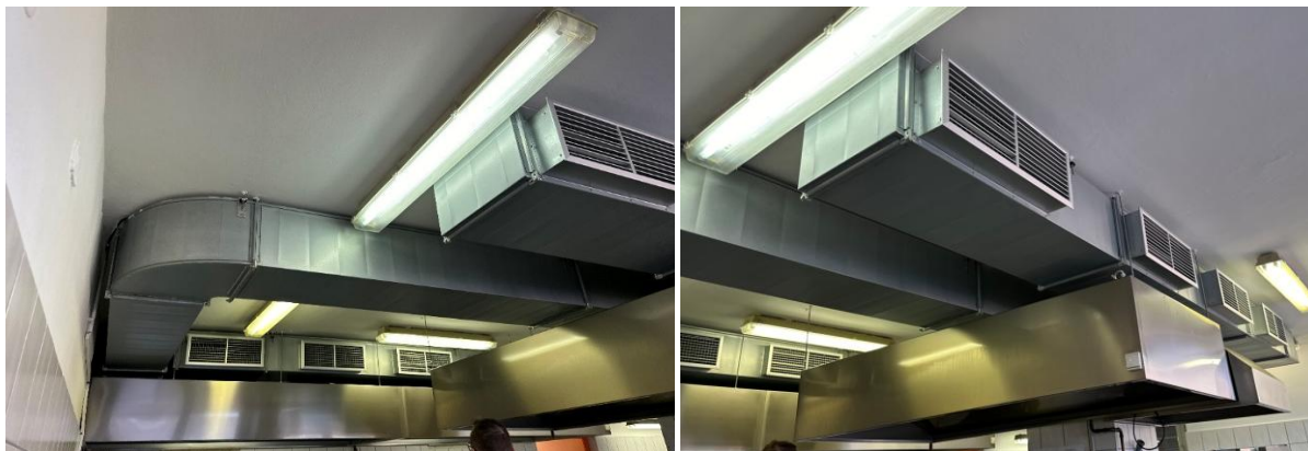
Obrázek 67 – VZT rozvody v kuchyni
