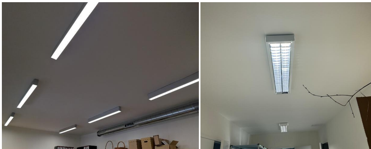
Obrázek 104 – Osvětlení zasedací místnosti, chodby
