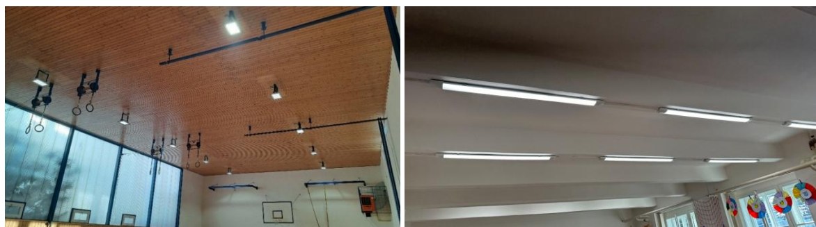
Obrázek 200 - Osvětlení v tělocvičně a učebnách
