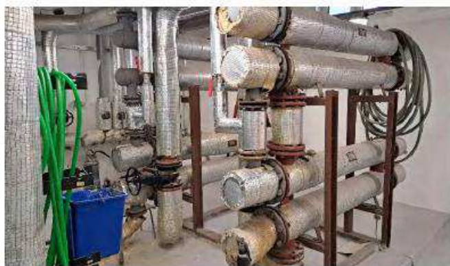
Ohřev TUV – výměníková stanice
