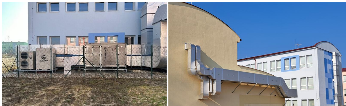
Obrázek 29 – VZT jednotka a vedení rozvodů po fasádě
