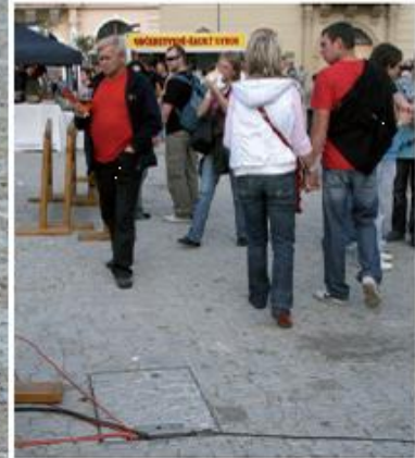
Podzemní rozvadeč v provozu
